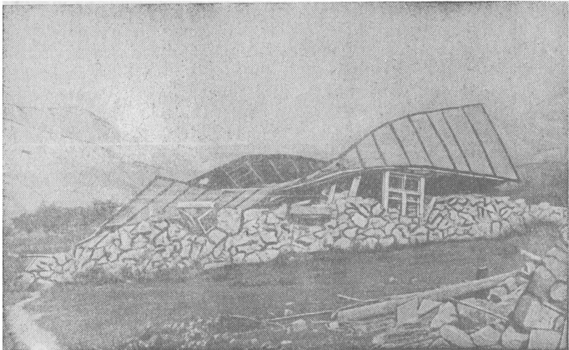
Рис. 8. Разрушенный дом при сотрясении силой 9 баллов; Хаитское землетрясение. Фото С. В. Медведева.
